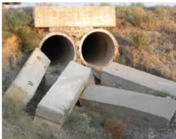
Рисунок 2 – Двухочковая водопропускная труба диаметром 1 м, км 15+525
